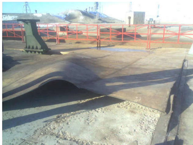
Рисунок 4 – Отрыв от железобетонного покрытия СС металлооблицовки при пуске РН «Протон» (26.12.2007)
